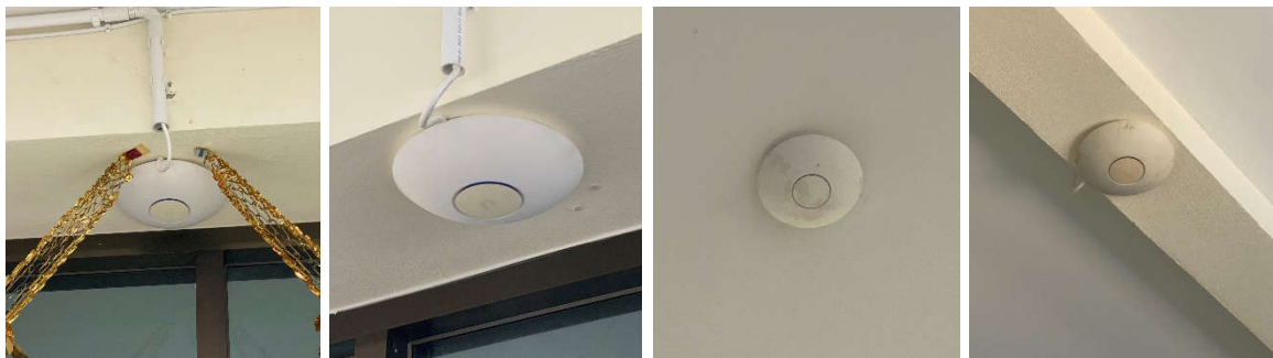
ติดตั้งจุดกระจายสัญญาณครอบคลุมอาคารละบริเวณสำนักงาน
